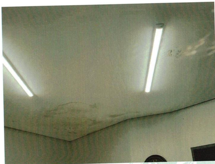
Figura 4 – Umidade e início de bolor na sala da presidência (Fonte: própria, no local)
