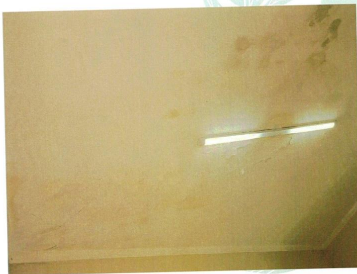
Figura 5 – Umidade e início de bolor no forro da Sala 06 (Fonte: própria, no local)
