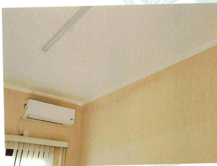
Figura 7 – Umidade abaixo da moldura de gesso da Sala 04 (Fonte: própria, no local)
