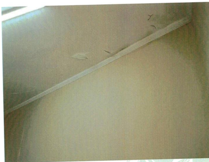
Figura 6 – Umidade e descascamento no forro da Sala 07 (Fonte: própria, no local)
