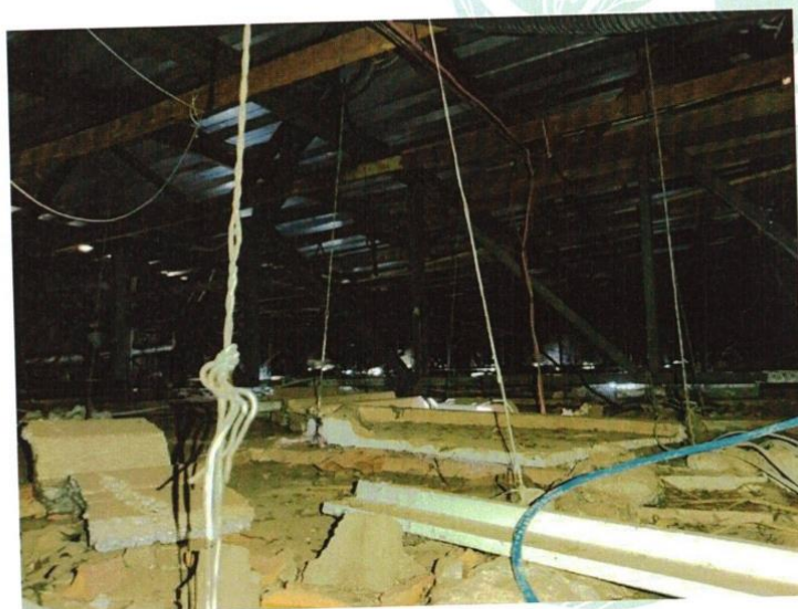
Figura 9 - Instalações elétricas entre o telhado e a laje (Fonte: própria, no local)
