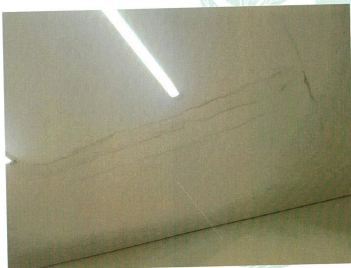
Figura 3 – Umidade n forro da sala da assessoria parlamentar jurídica (Fonte: própria, no local)
