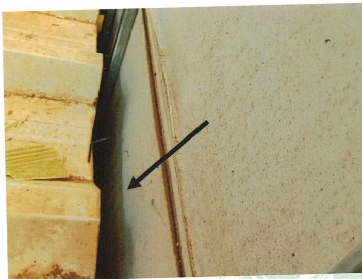
Figura 14 – Possível área de infiltração entre a parede e as telhas (Fonte: Luís Gustavo, no local)
