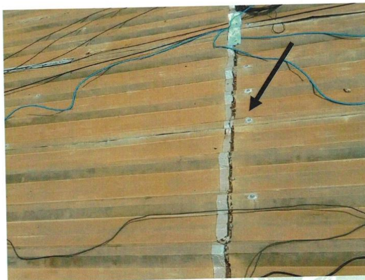
Figura 16 – Vedações ressecadas e fiação exposta (Fonte: Luís Gustavo, no local)
