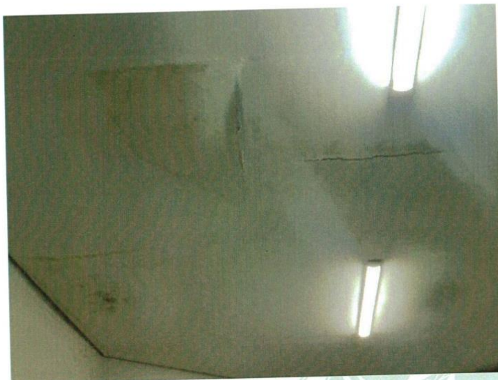
Figura 2 – Umidade e descascamento no forro da secretaria (Fonte: própria, no local)
